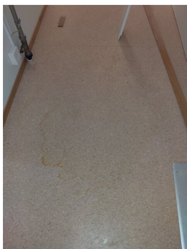
Fuktbetingade skador på plastmatta i korridoren på BV
