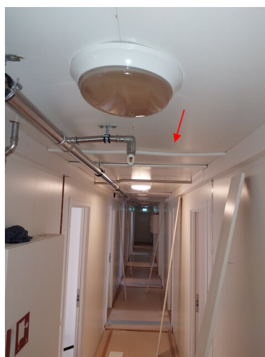
Vattenfylld plafond Innertak har svällt i korridor på BV
