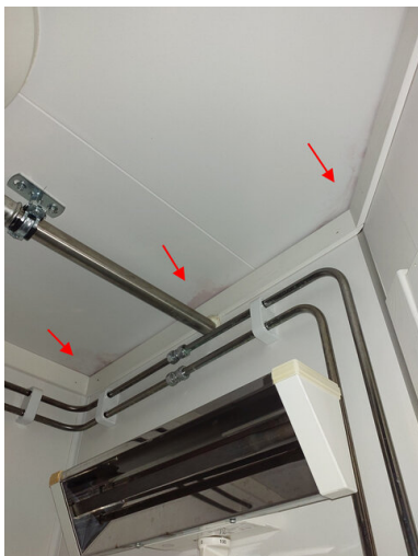
Fuktbetingade skador i innertak i badrum på BV noteras i flertal lägenheter
