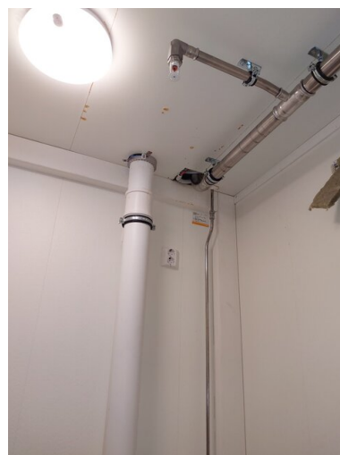
Fuktbetingade skador i innertak Förråd BV
