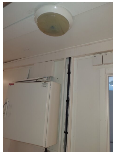
Vatten har runnit ner från ÖV till BV och gjort skador på väggar och el-central
