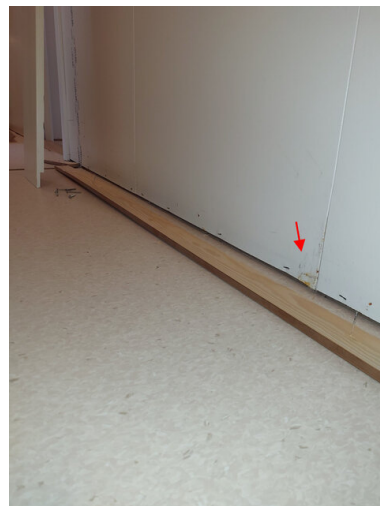
Svällskador på nedre delar av skivbeklädnad på övervåning i korridor
