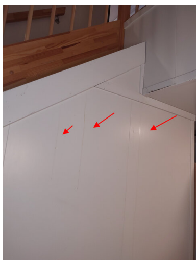
Vatten har runnit nerför trapp och jäms med väggar
