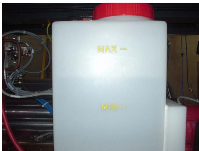
Figur 21. Avkylningsvattentank med invändig jonisk växlare.
