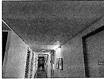
Figur 13: Korridor, skador finns ovanför undertak
