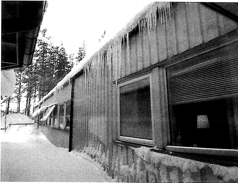
Figur 15: Plintgrund under snötäcke, samt isbildning tak
