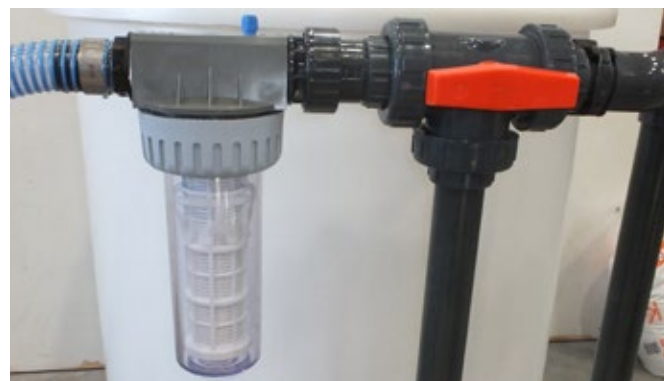
Filter och 3-vägs ventil
